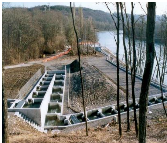
Passé à poissons au barrage de Verbois
